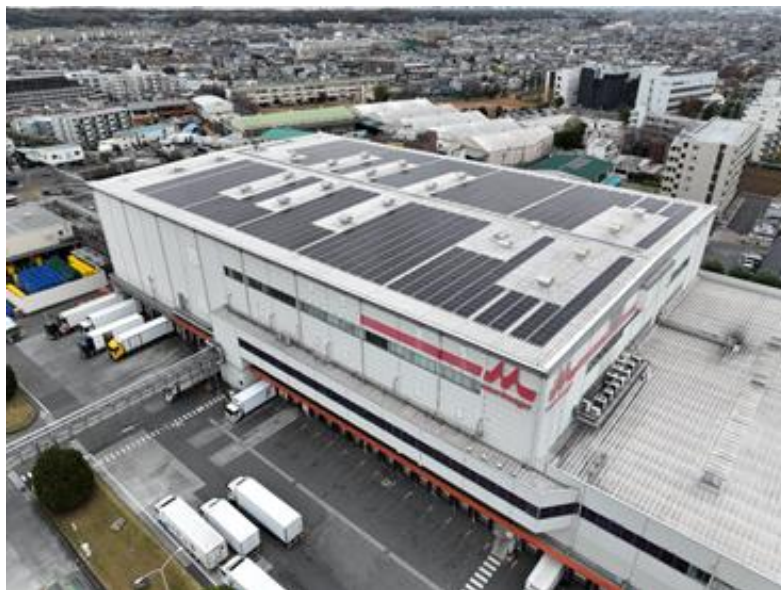
増設した東京多摩工場の太陽光発電設備
